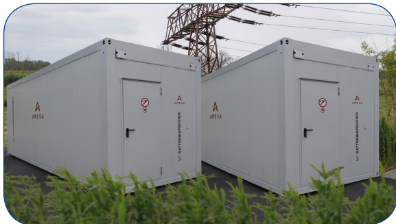
Batteriespeicher im AREVA 40'-Container
