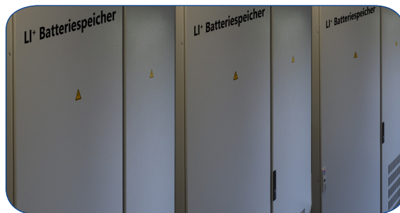
Schaltschränke für Leistungselektronik
